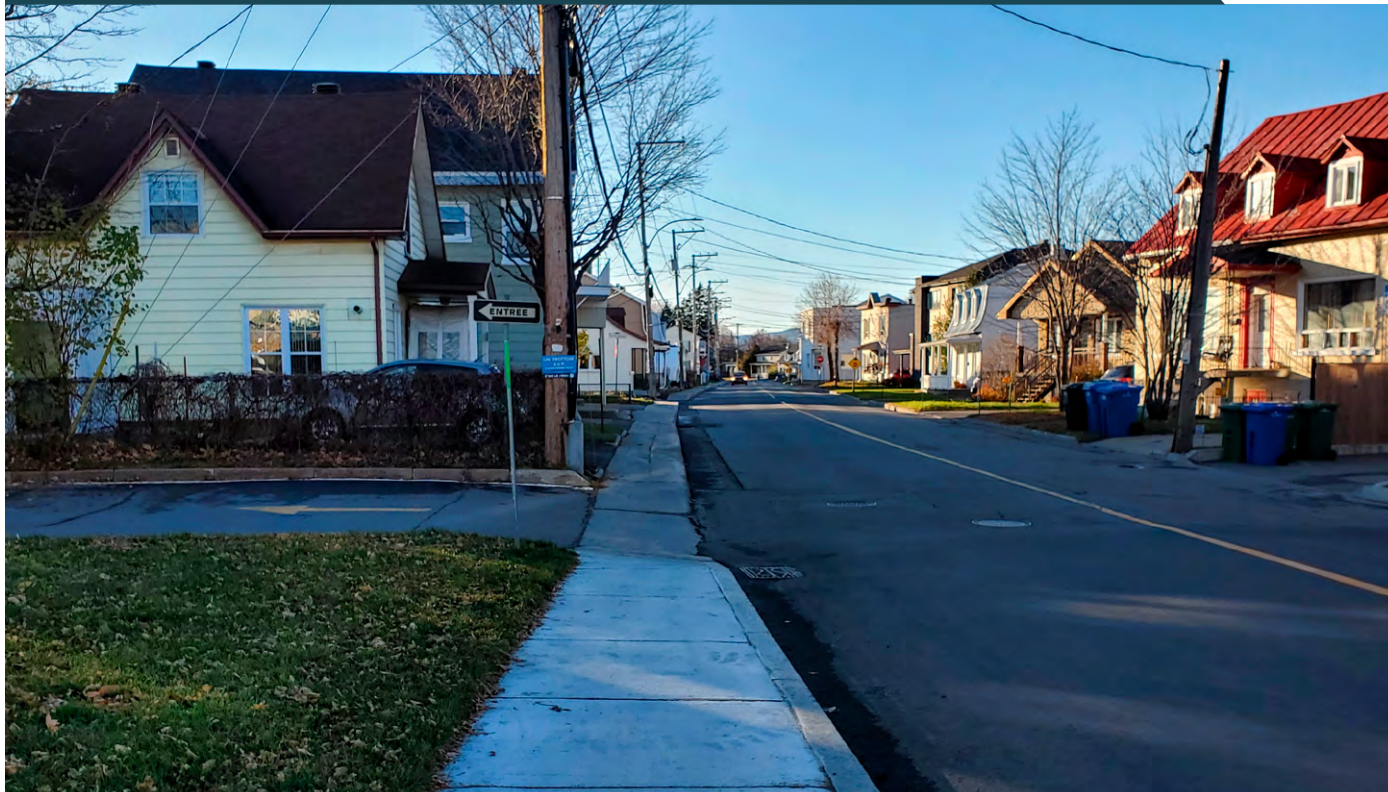
FIGURE 19. Trottoir d'une largeur restreinte d'un seul côté de la rue et joints tracés à la truelle - rue Saint-Jacques
