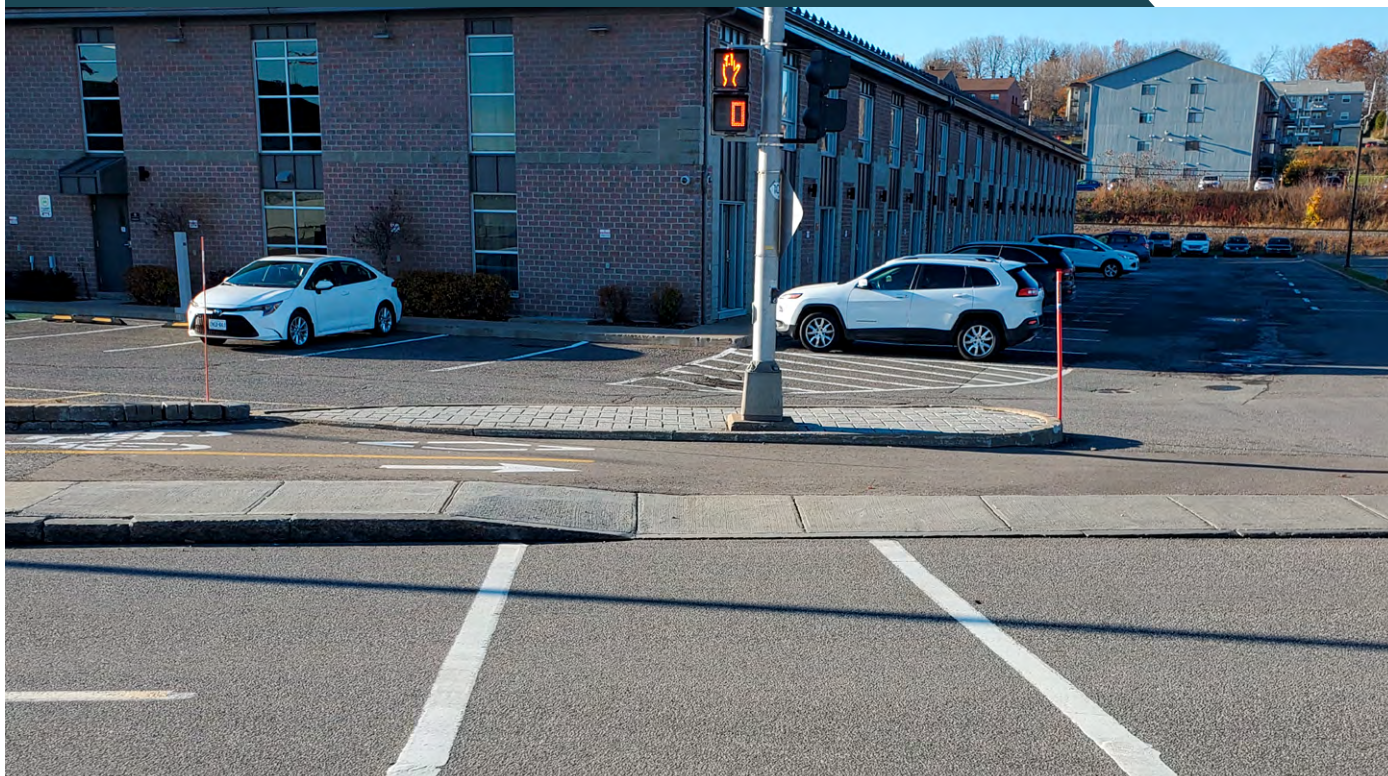
FIGURE 18. Passage piéton sans rampe - Intersection du boulevard Wilfrid-Hamel et l'avenue Jules-Verne
